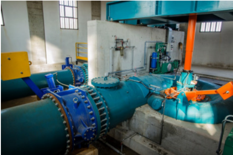
2 turbine FRANCIS Gruppo 1: 560 kW Gruppo 2: 285 kW
